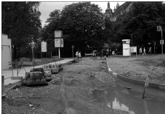
Gleviner Mauer 3. BA - Probleme mit dem Regenwasser
